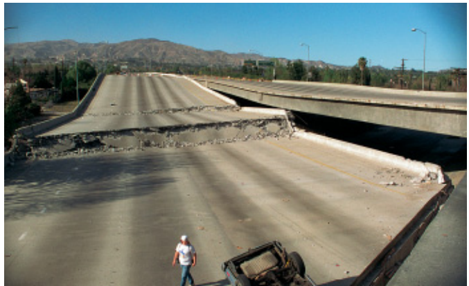
En sammenstyrtet motorvejsbro i Californien
