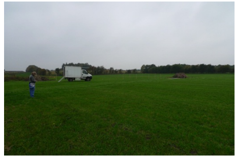
Oversigt over marken hvor den horisontale boring etableres. Til højre udgravningen hvorfra der "bores". Til venstre for bilen udgravningen hvor rør og slanger kommer ud og samles i en brønd.
