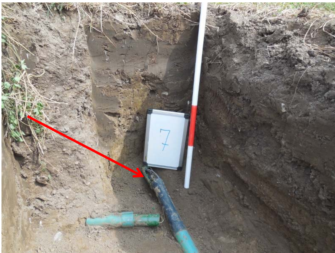
Figur 3-2. Beskadiget beskyttelsesrør, rød pil viser området hvor beskyttelsesrøret er delvist knust
